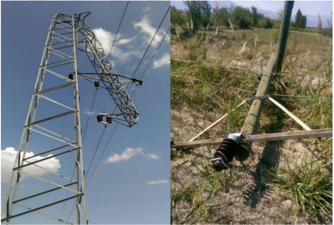
Şekil 4.25. Rüzgâr nedeniyle oluşan arızalar
