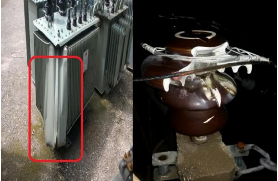
Şekil 4.26. Şarjlı havalarda yıldırım kaynaklı oluşan arızalar
