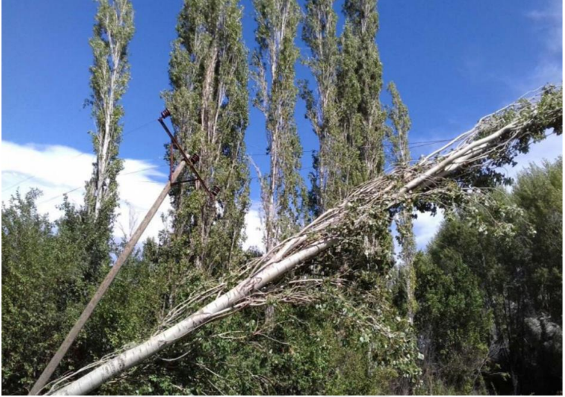
Şekil 4.30. Ağaç devrilmesi sonucu oluşan arızalar
