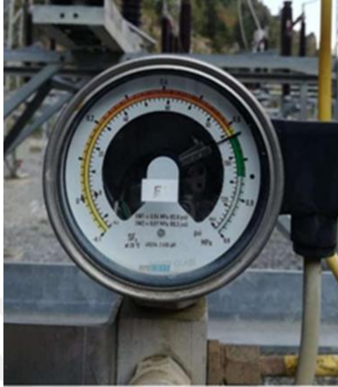
Şekil 4.21. Sf6 gaz manometre, Sf6 gaz yoğunluğu göstergesi
