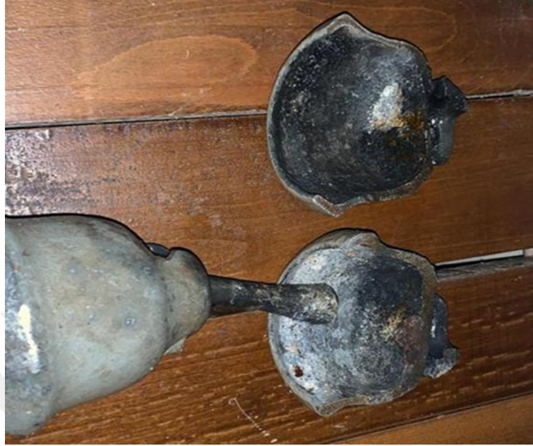
Şekil 4.20. Gergi izolatörünün patlaması
