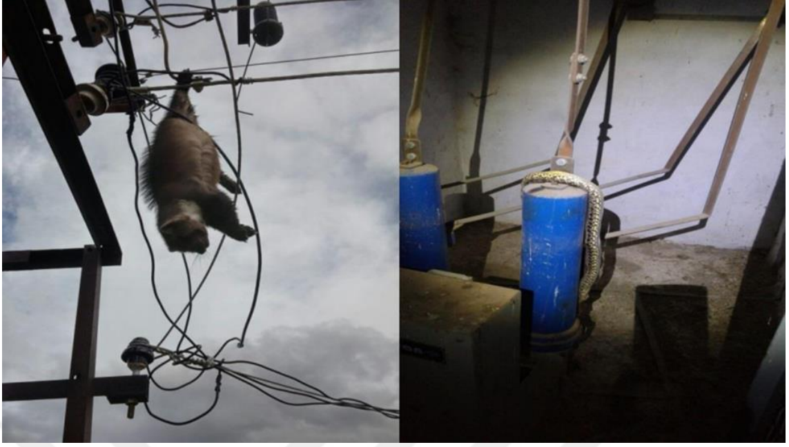
Şekil 4.28. Hayvan kaynaklı oluşan arızalar Kaynak: (Çifçi vd, 2017: 10)
