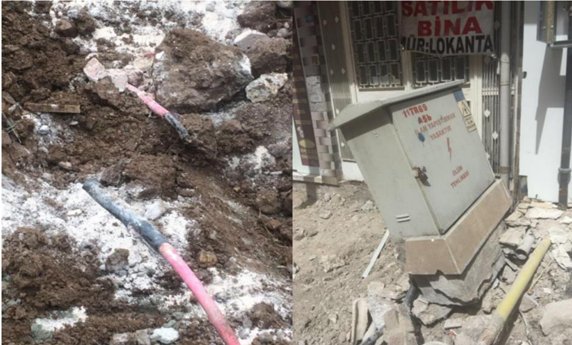
Şekil 4.31. Kazı çalışmalarından kaynaklı arızalar
